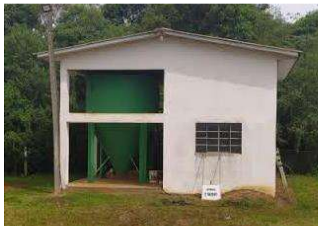
Figura 33 - Tratamento físico-químico inoperante.
