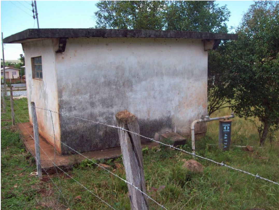
Figura 24: Captação subterrânea de água bruta no Poço 01 Fonte: Consórcio SOTEPA/IGUATEMI/AR
