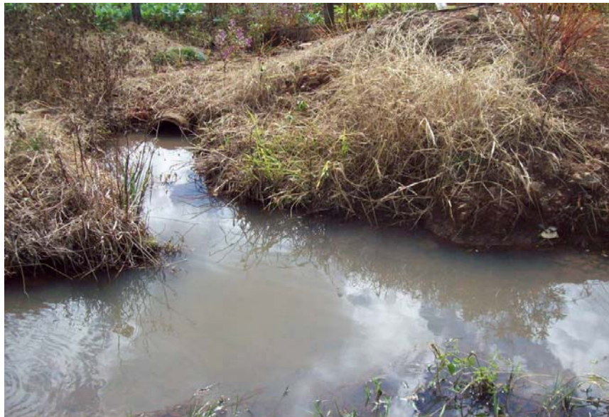
Figura 40: Ponto de alagamento do Rio Fartura Fonte: Consórcio SOTEPA/IGUATEMI/AR
