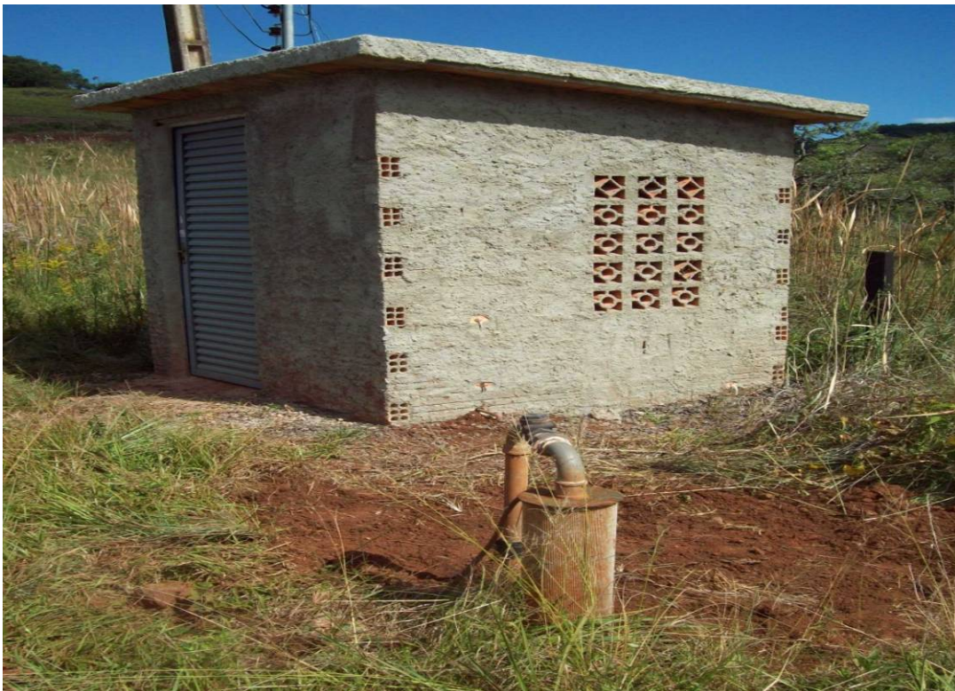
Figura 25: Captação subterrânea de água bruta no Poço 02 Fonte: Consórcio SOTEPA/IGUATEMI/AR
