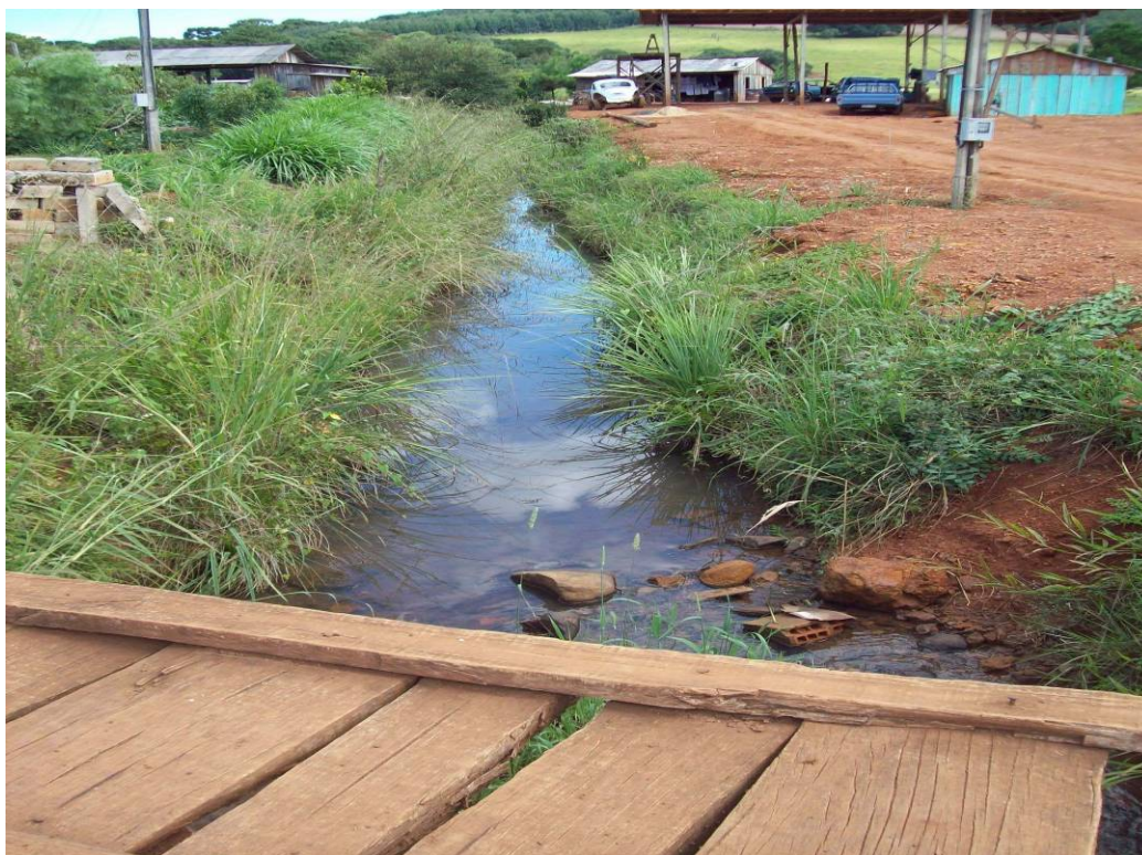
Figura 43: Ponto de alagamento do Riacho Palmares Fonte: Consórcio SOTEPA/IGUATEMI/AR
