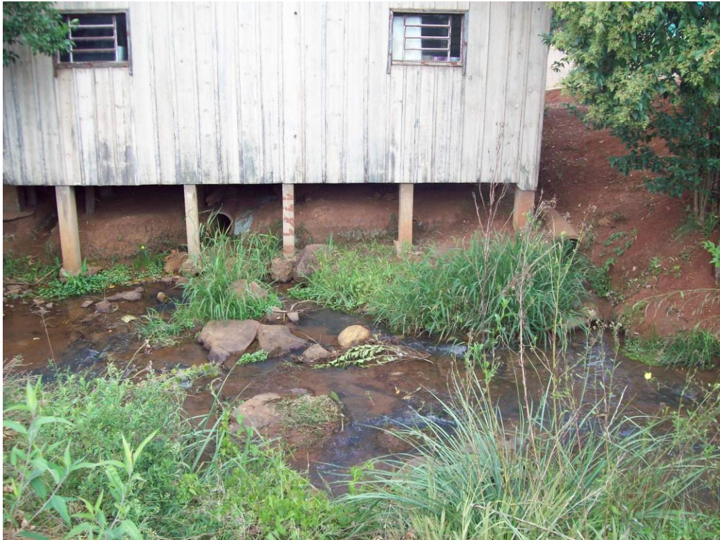
Figura 50: Ocupação das margens do Riacho dos Palmares Fonte: Consórcio SOTEPA/IGUATEMI/AR
