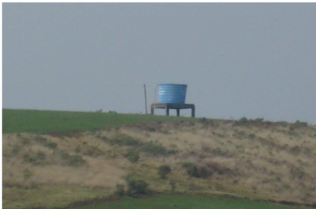
Figura 31: Reservatório R4 que atende a Vila Weber de Brunópolis Fonte: Consórcio SOTEPA/IGUATEMI/AR
