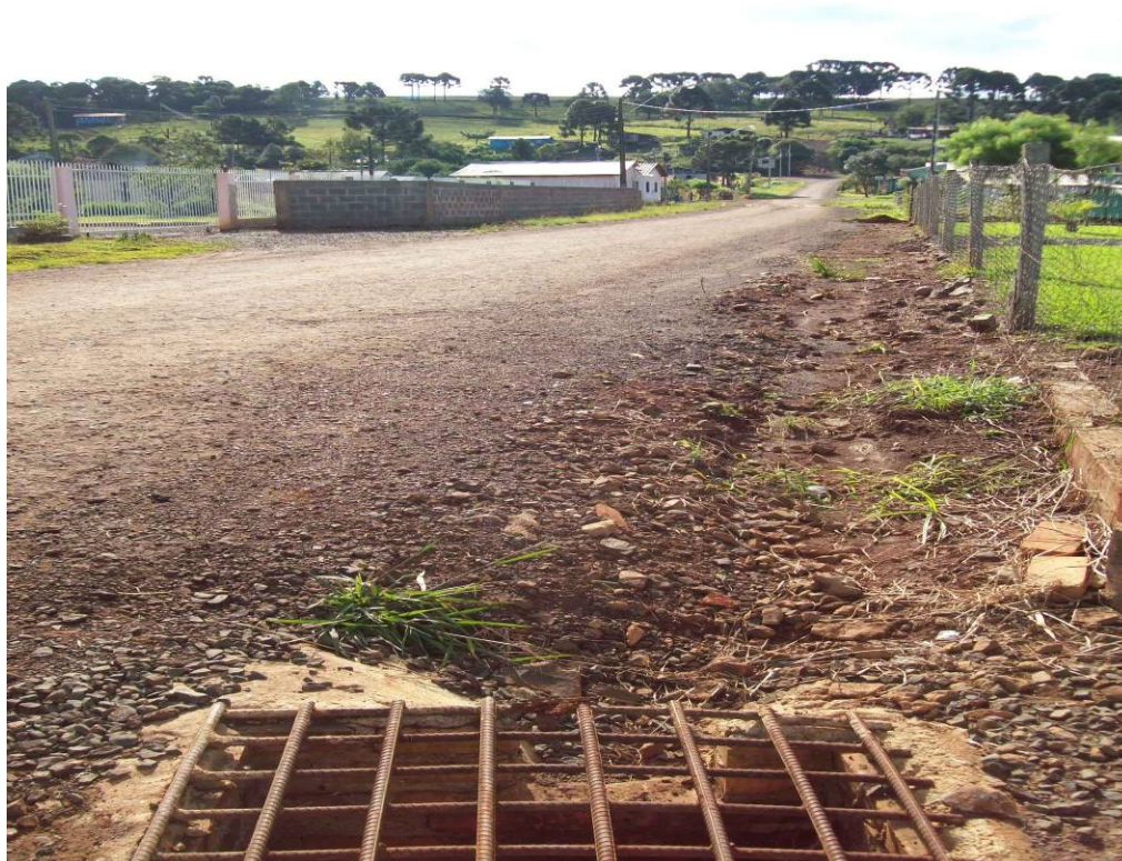
Figura 54: Ponto sujeito a alta carga de escoamento pluvial superficial Fonte: Consórcio SOTTEPA/IGUATEMI/AR
