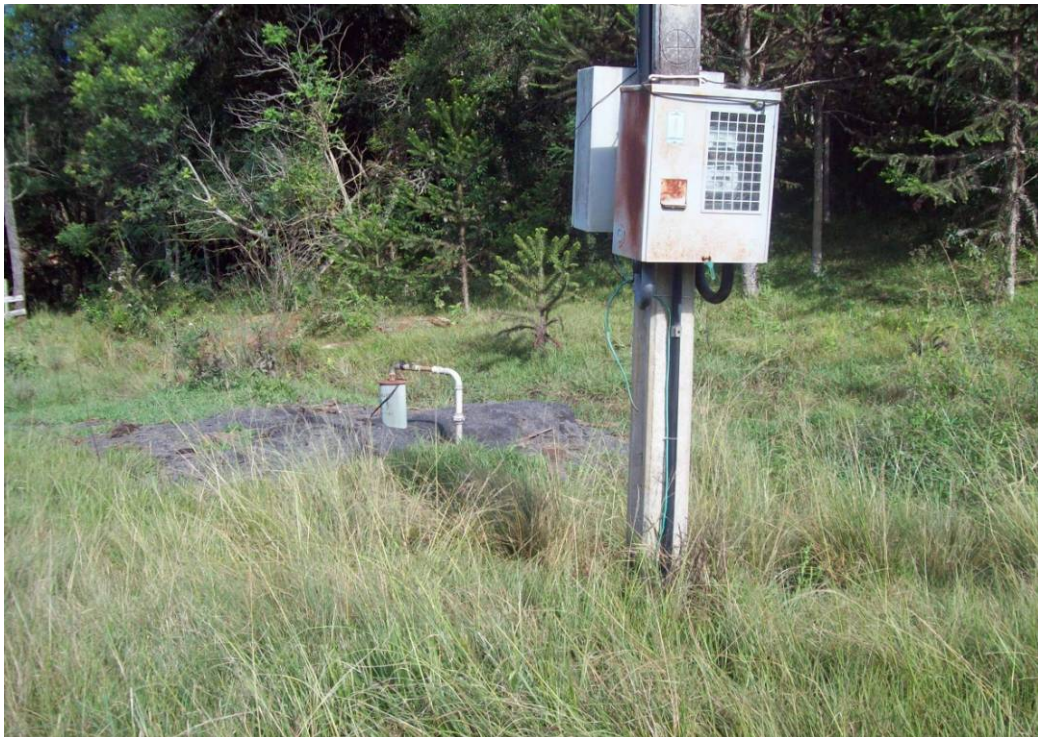
Figura 27: Captação subterrânea de água bruta no Poço 04 Fonte: Consórcio SOTEPA/IGUATEMI/AR
